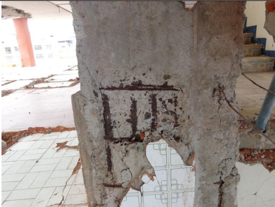
Corrosión en varillas longitudinales y estribos en columna central del tercer piso, no cumple con el recubrimiento de hormigón establecido por la norma NEC 2015.
