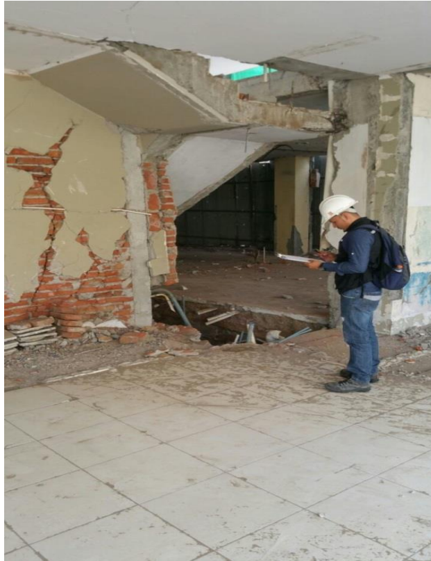
Fotografía #5 Evaluación de los daños estructurales y no estructurales de la edificación.
