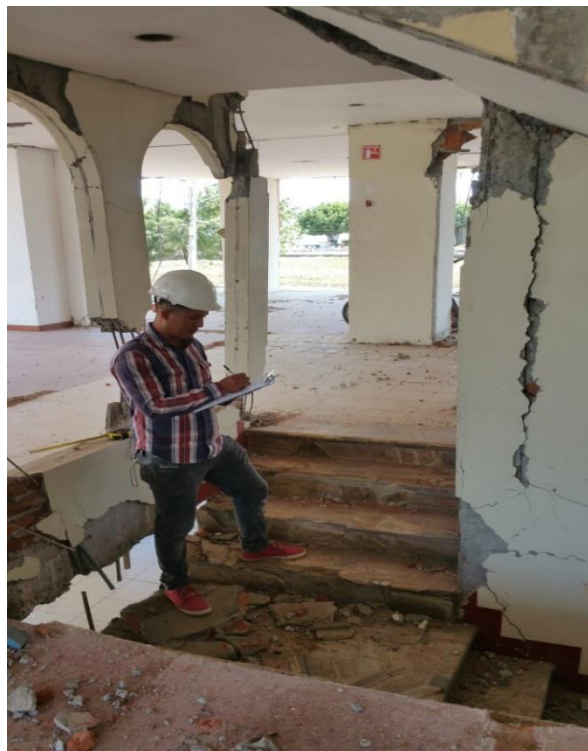
Fotografía #5 Evaluación de los daños estructurales y no estructurales de la edificación.
