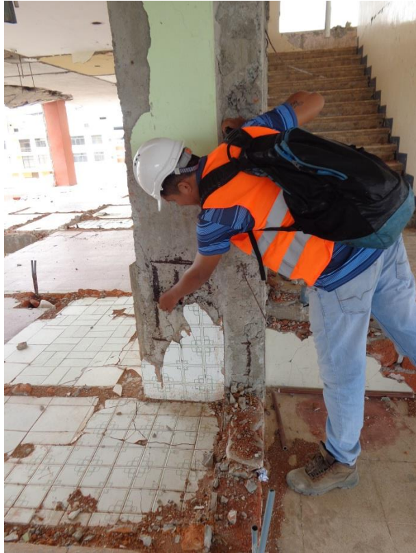
Fotografía #3 Inspección de los elementos dañados.
