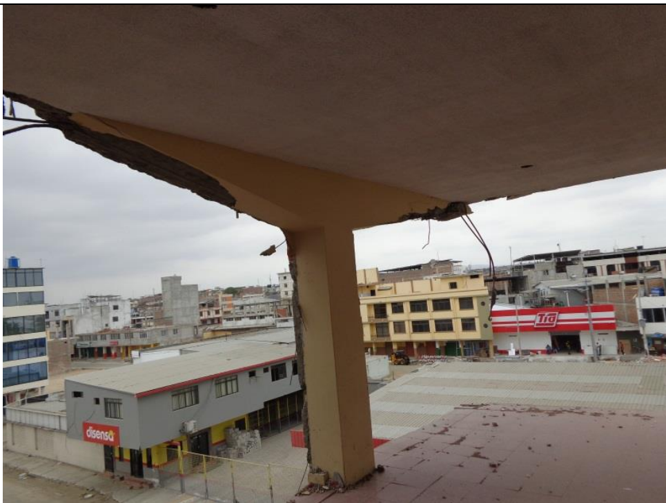
Daño parcial en el recubrimiento de hormigón en cartela por colapso de edificación vecina.
