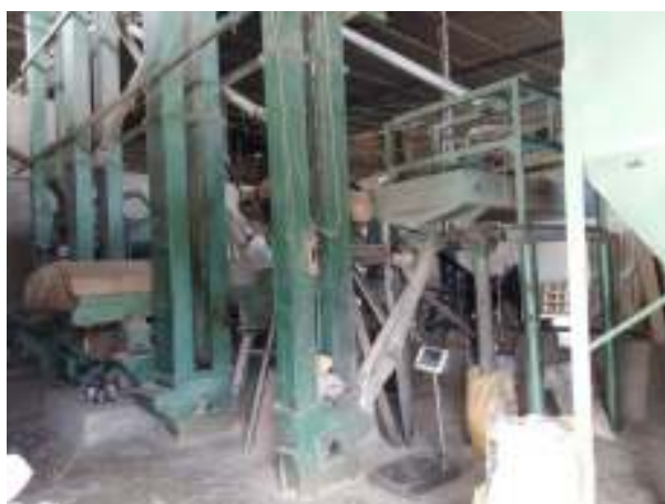
Anexo 9; Piladora Nacho maquinarias instaladas
