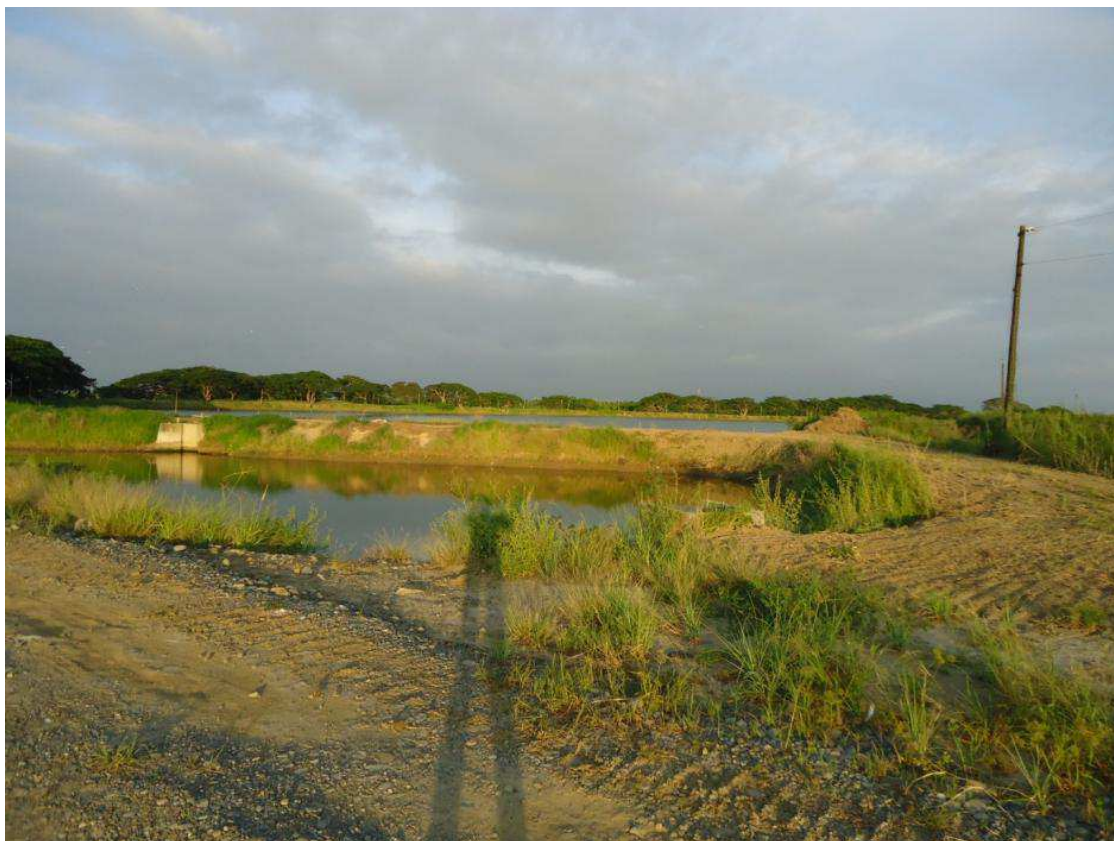
Anexo 10: grandes barricadas de tierra extraídas para la construcción de las piscinas.
