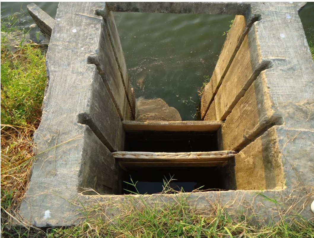
Anexo 15: Desecho de aguas servidas que van directo al estero.
