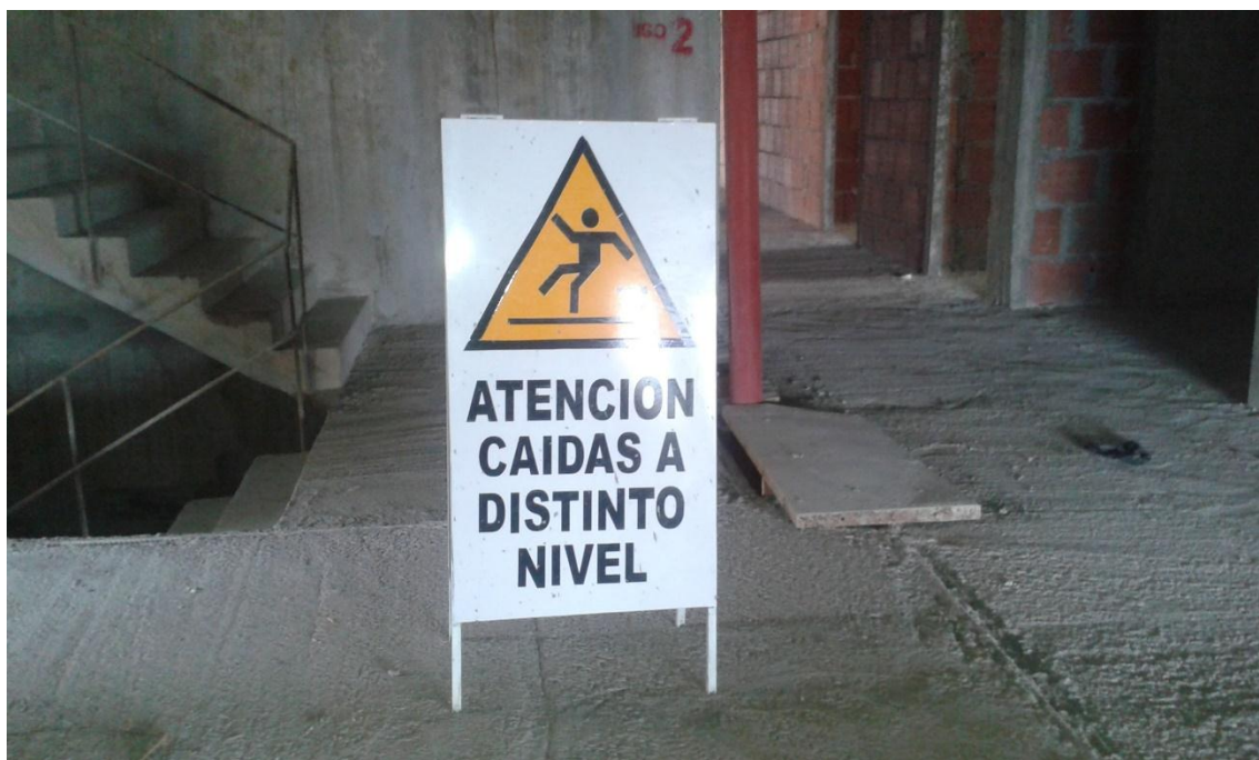
Foto No. 8. Señalización horizontal
