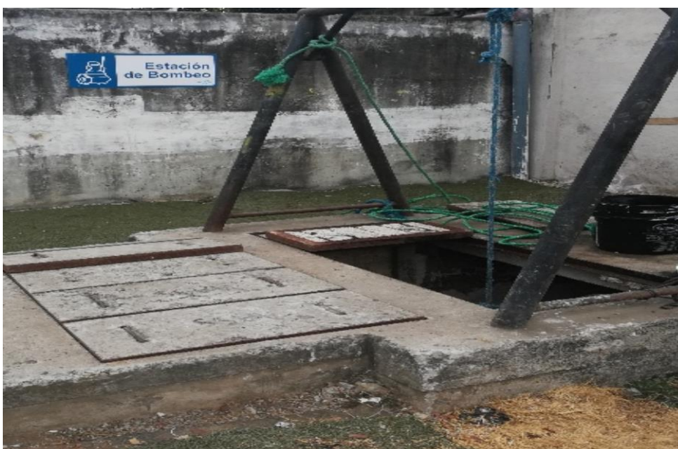
Ilustración 19: Estación de bombeo Urbanización Laguna del Sol KM 8 Vía a Samborondòn (Planta de tratamiento de lodos activos).
