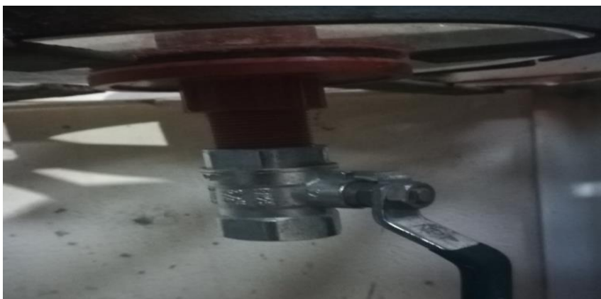
Ilustración 12: Llave y acople de 1/2 pulgada para la evacuación del AA.SS
