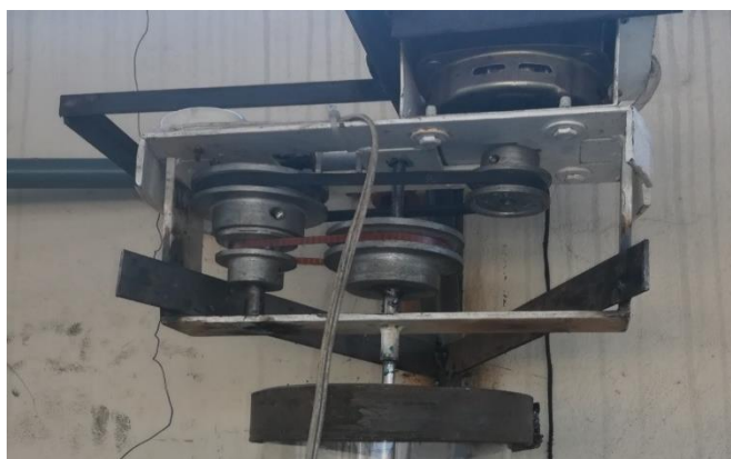
Ilustración 9: Soportes de hierro y platinas para estabilidad.
