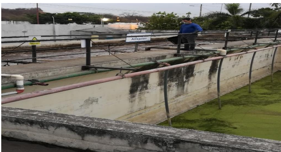
Ilustración 23: Tanque de aireación de planta de tratamiento
