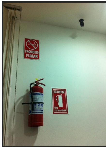
Foto 18: Extintor y señalética “No fumar” (Área administrativa)
