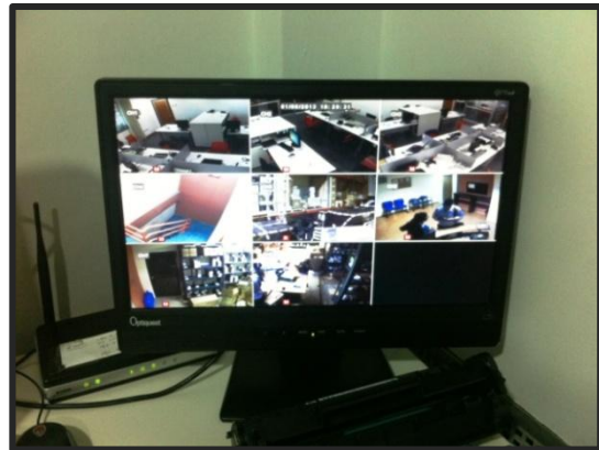
Foto 5: Monitoreo de cámaras de seguridad
