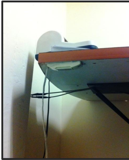
Foto 12: Único botón de pánico instalado en Caja
