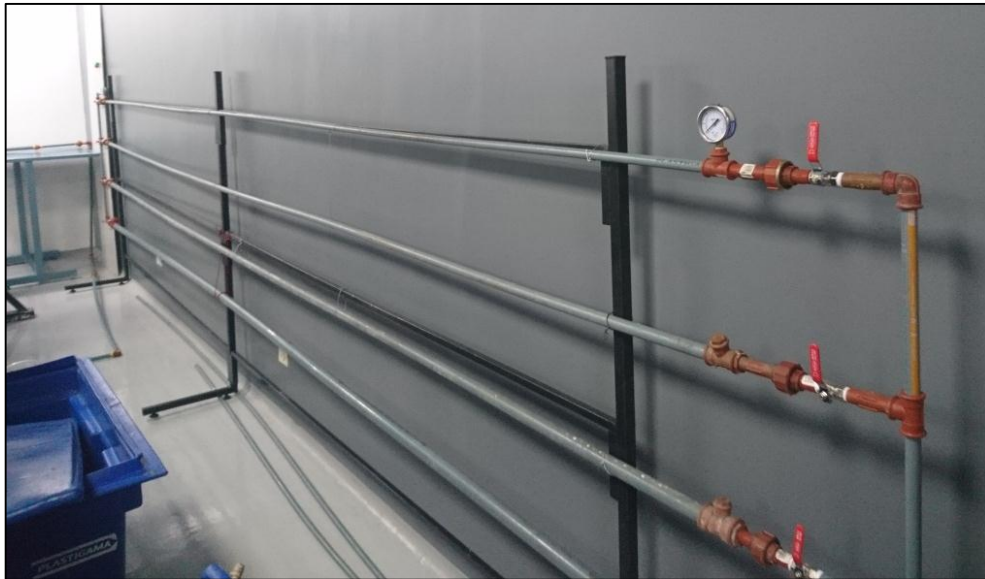
Ilustración 27: Equipo Instalado. Elaborado por: Fuentes M., & Macías k. (2019)
