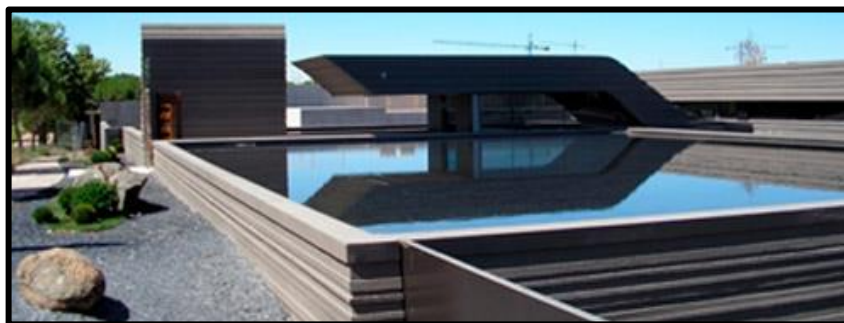
Figura 22: Cubierta inundada. Fuente: Google (2019)
