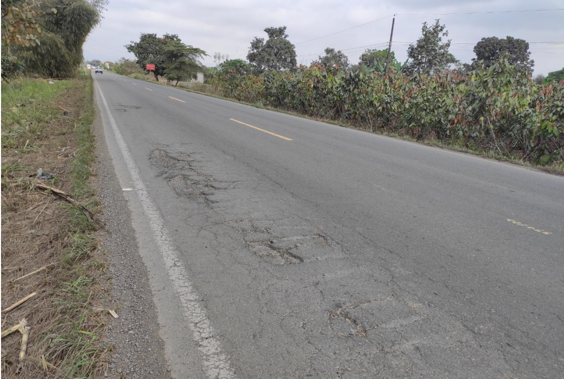
Anexo 13 Estado de la carpeta asfáltica
