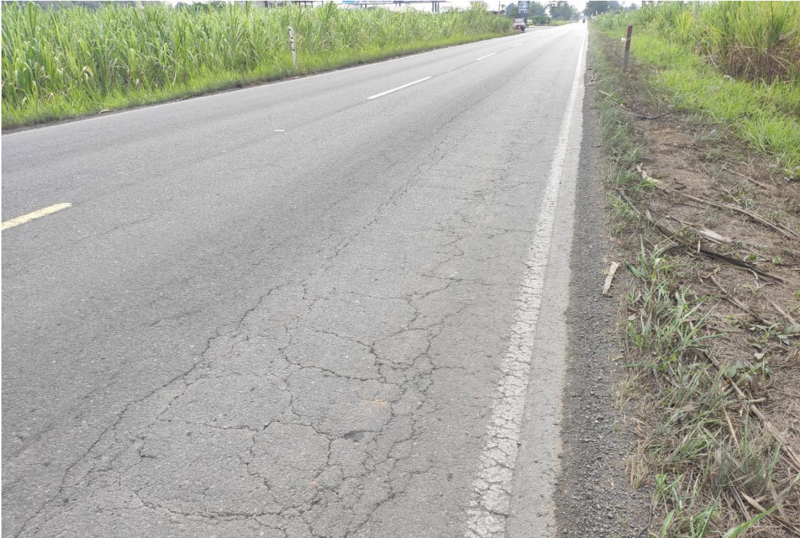
Anexo 12 Estado de la carpeta asfáltica
