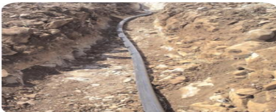
Ilustración 5: instalación en grieta (ABN PIPE SYSTEM)
