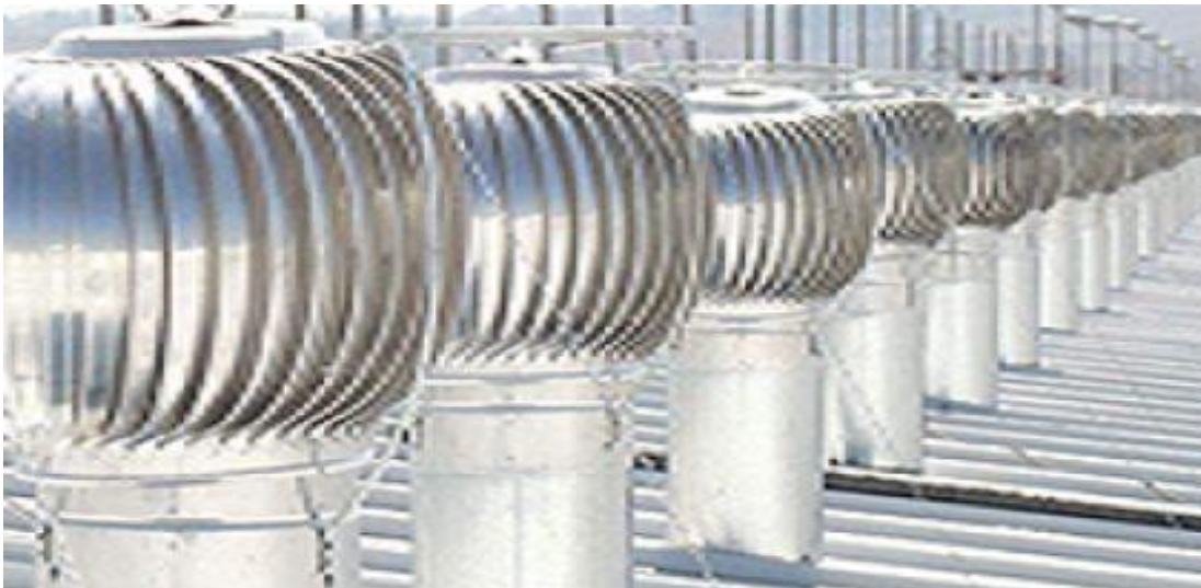
Figura 4. Sistema de ventilación industrial, tomado de la empresa HVAC INGENIERÍA S.A Elaborado por: Velasco (2020)
