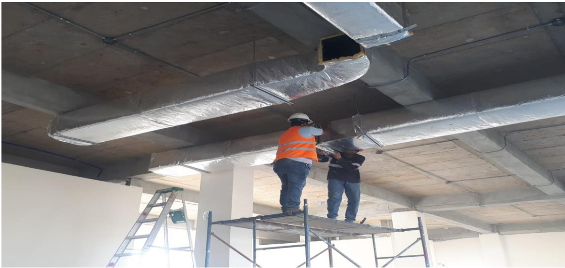
Figura 8. Mantenimiento de sistemas de conducción de aire acondicionado, tomado de la empresa HVAC INGENIERÍA S.A Elaborado por: Velasco (2020)
