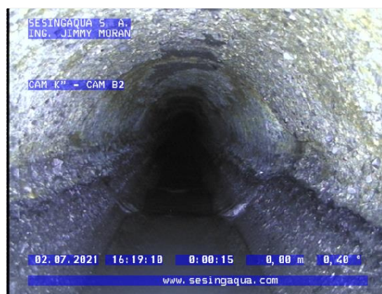
Figura 55. Inspección Cam k – cam b2 -0001
