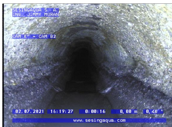
Figura 54. Inspección Cam k – cam b2 - 0000
