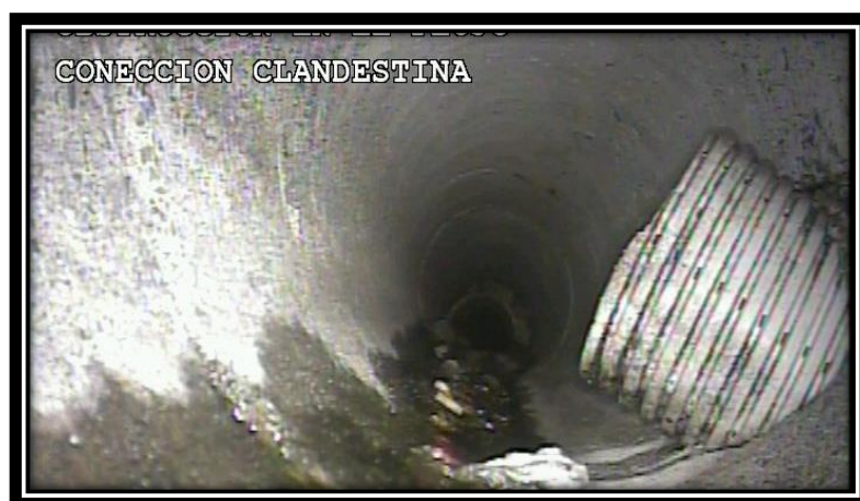
Figura 10. Obstrucción en tubería , red clandestina. Elaborado por: Villafuerte, L. (2022)
