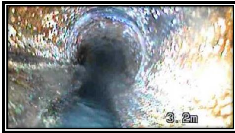
Figura 13. Desplazamiento de tubería de hormigón armado. Elaborado por: Villafuerte, L. (2022)
