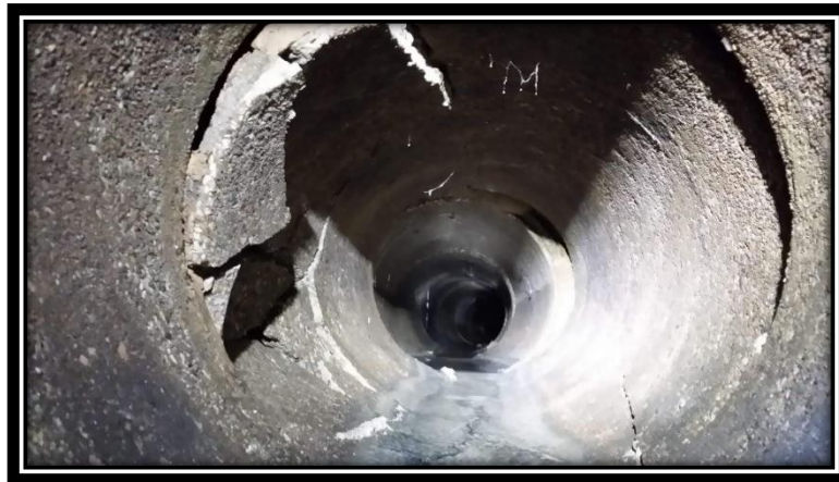
Figura 16. Fractura en tubería de hormigón armado.. Elaborado por: Villafuerte, L. (2022)
