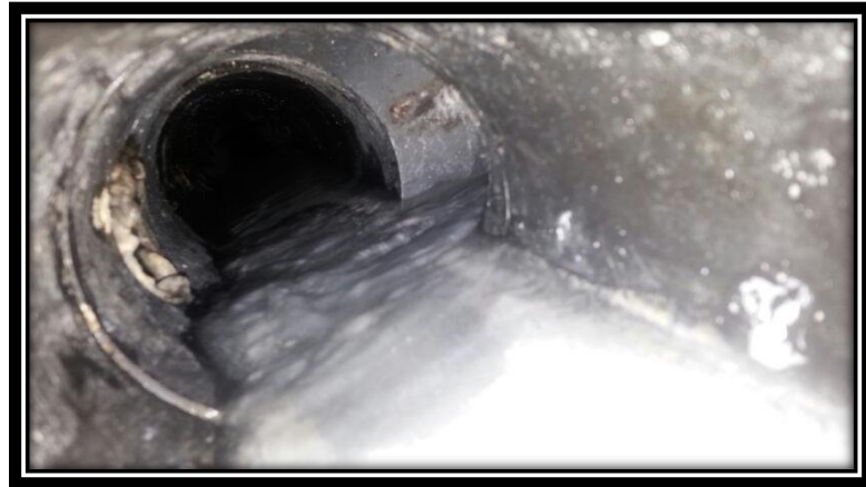
Figura 11. Desplazamiento de tubería de hormigón armado. Elaborado por: Villafuerte, L. (2022)
