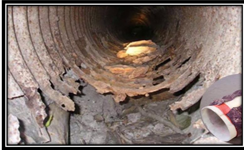
Figura 17. Colapso de tubería PVC. Elaborado por: Villafuerte, L. (2022)
