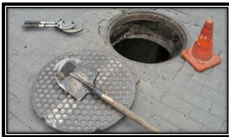
Figura 19. Pozos de revisión aguas residuales. Elaborado por: Villafuerte, L. (2022)
