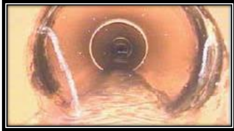
Figura 9. Infiltración en el interior de tubería. Elaborado por: Villafuerte, L. (2022)
