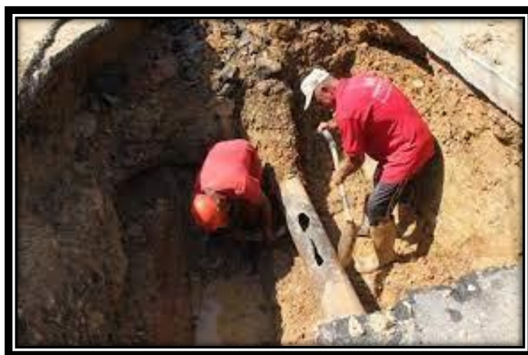
Figura 43. Mantenimiento Correctivo Elaborado por: Villafuerte, L. (2022)
