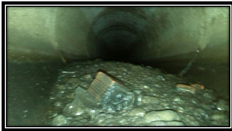
Figura 8. Obstrucción de Roca en tubería Elaborado por: Villafuerte, L. (2022)
