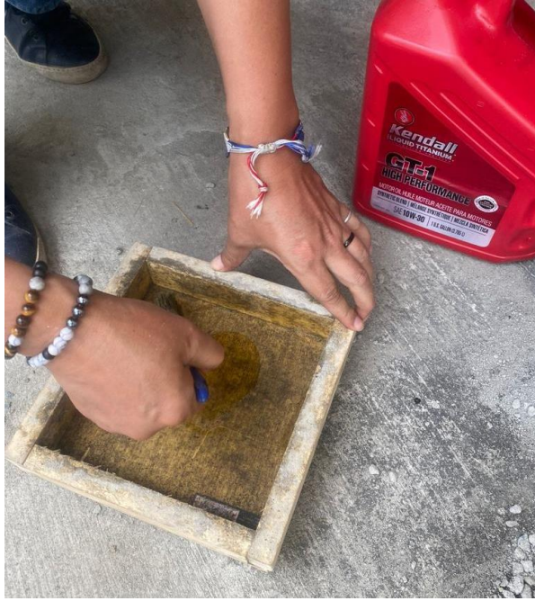
Figura 34 Aceite de motor para el encofrado del prototipo PTYH 03 Elaborado por: Contreras & Montalván (2022)
