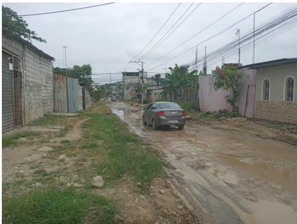
Figura 4. Calle en malas condiciones. Elaborado por: Alvarado, R. y Romero, L. (2022).
