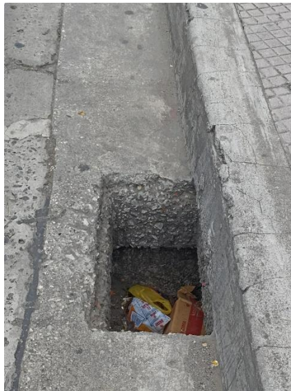
Figura 5 Sumidero tipo rejilla incompleto en sector la Rotonda
