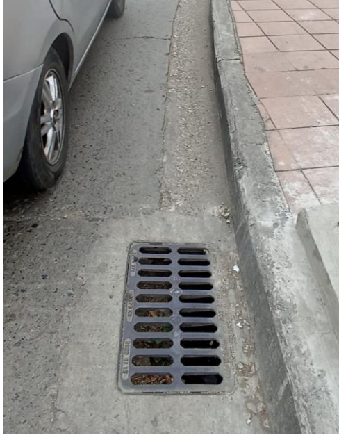
Figura 6 Sumidero tipo rejilla ubicado en la Av. Benjamín Carrión
