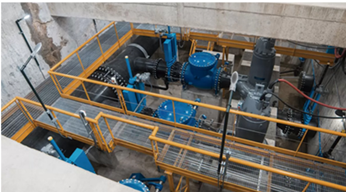
Figura 16. Estación de Bombeo La Pradera. Guayaquil, Ecuador
