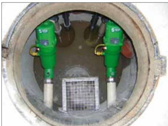
Figura 35. Válvulas de Vacío
