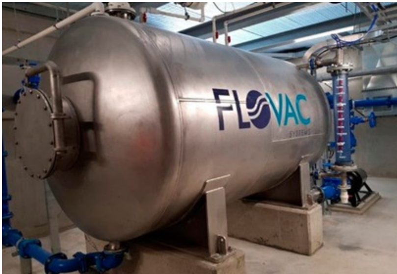
Figura 37. Tanque de Vacío
