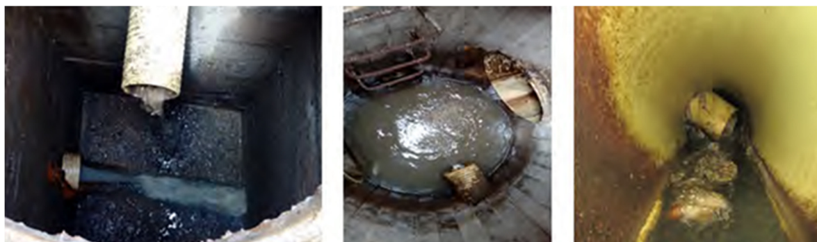
Figura 2. Problemas frecuentes en Sistemas de Alcantarillado
