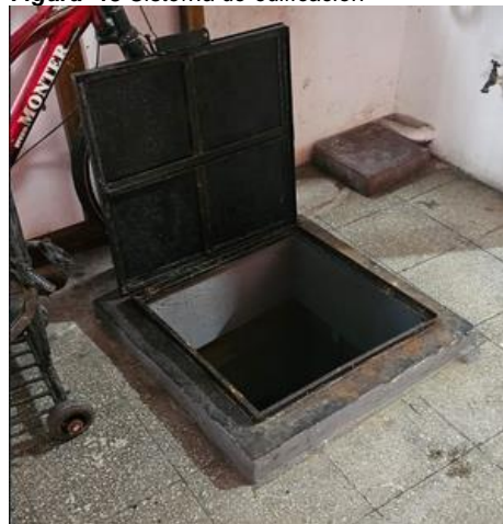
Figura 43 Cisterna de edificación
