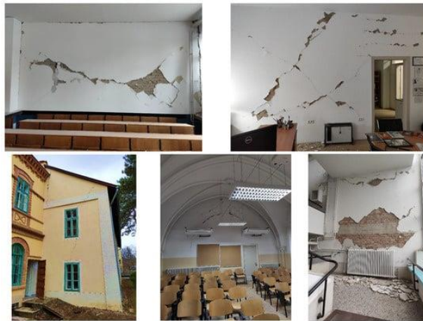
Figura 13 Evaluación de daños posteriores al terremoto
