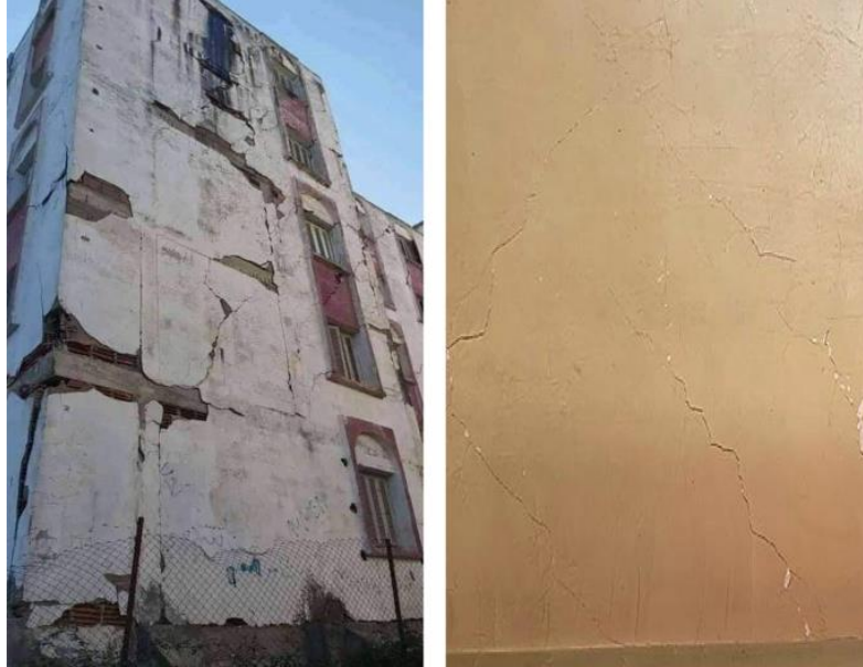
Figura 31 Grietas exteriores e internas
