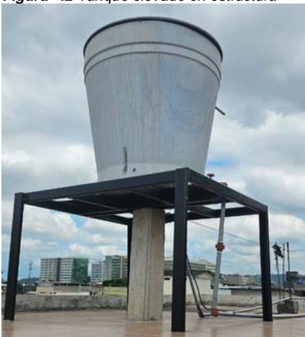
Figura 42 Tanque elevado en estructura
