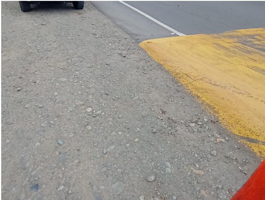
Señalética de zona escolar mal ubicada
