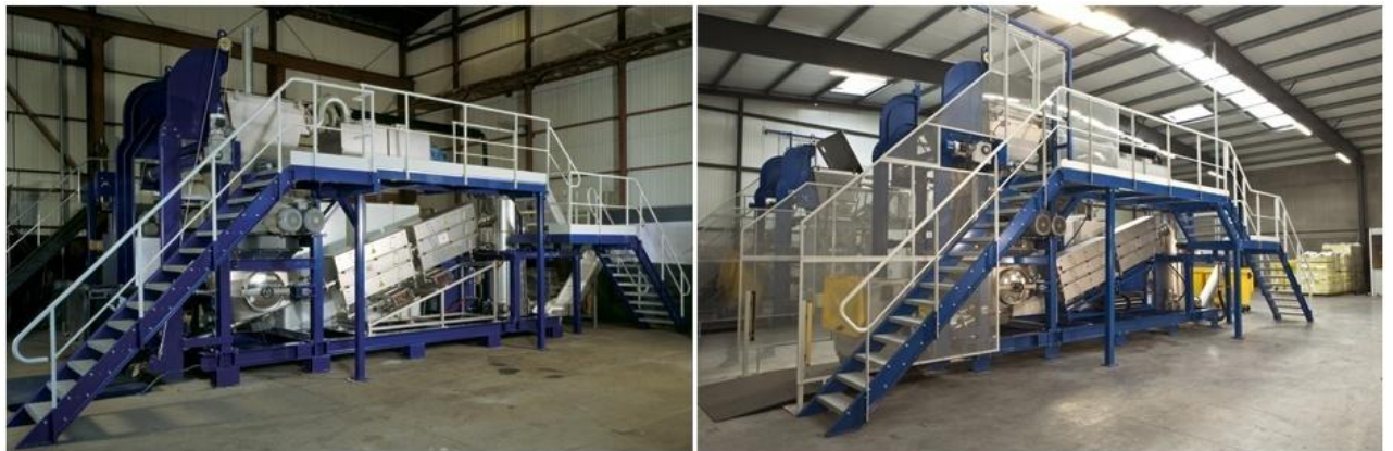
FIGURA N° 35 EQUIPO DE TRATAMIENTO
