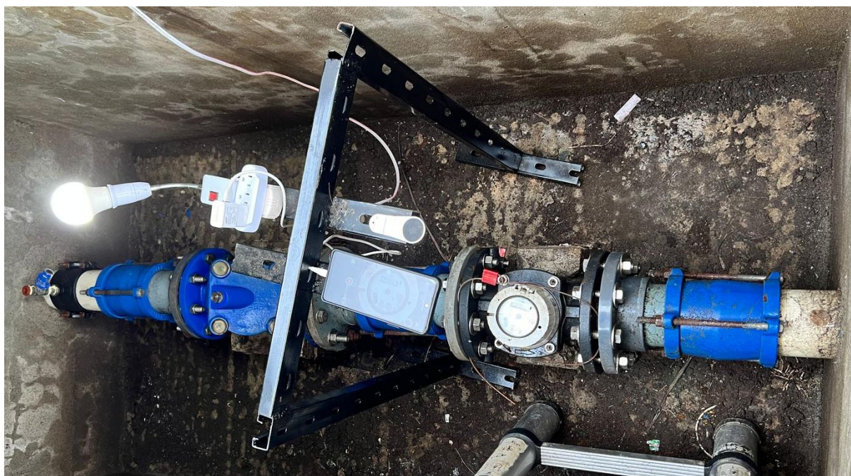
Figura 5 Medidor de flujo instantáneo.
