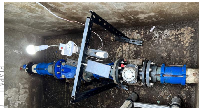
Foto: Medidor general de Agua Potable
