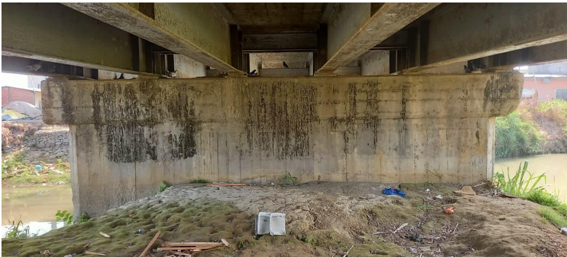
Figura 1. Vista inferior de la pila central del puente (signos de humedad y biodeterioro).
