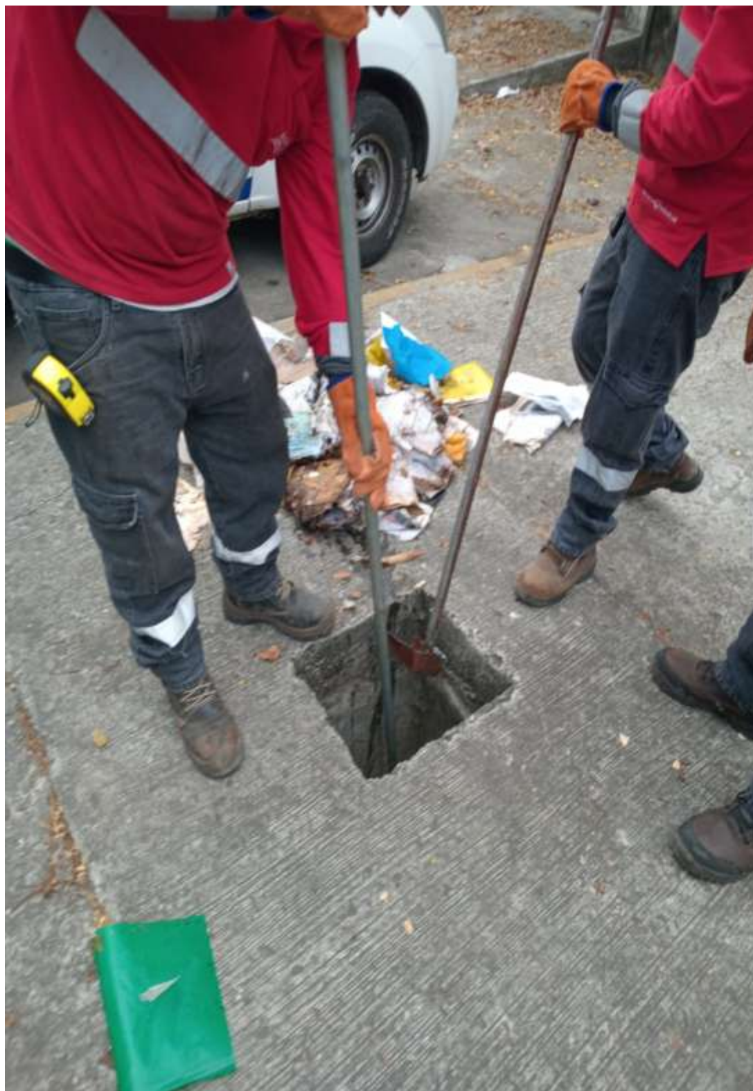
Figura 32. Cajas de registro con plásticos
