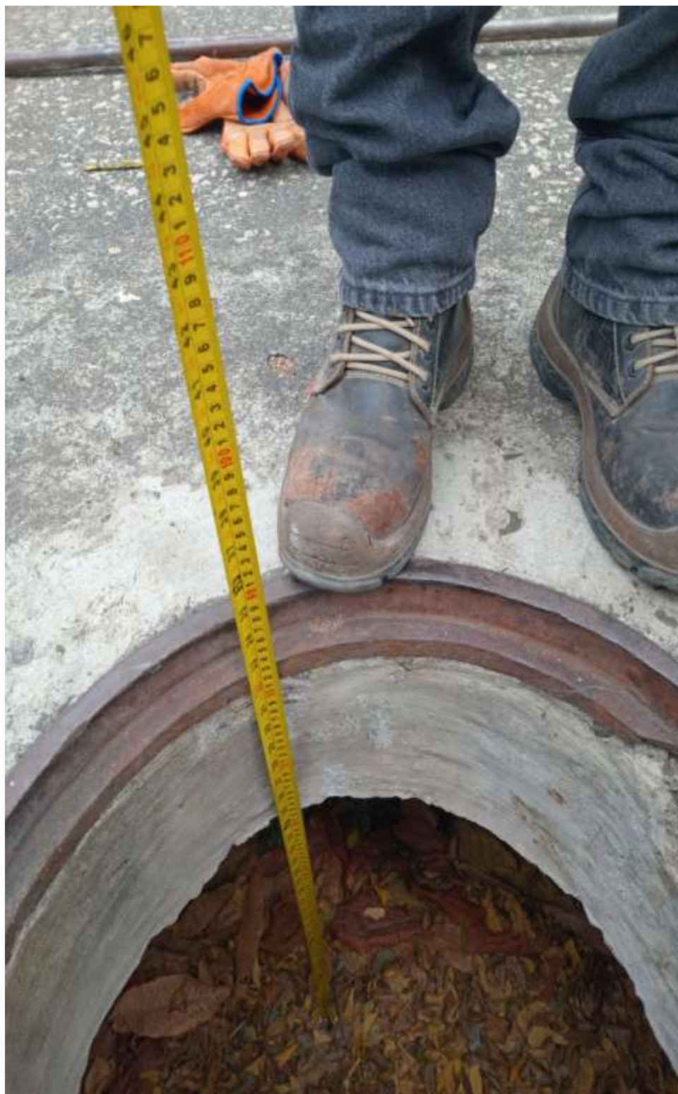
Figura 31. Tuberías casi completas de residuos y desechos
