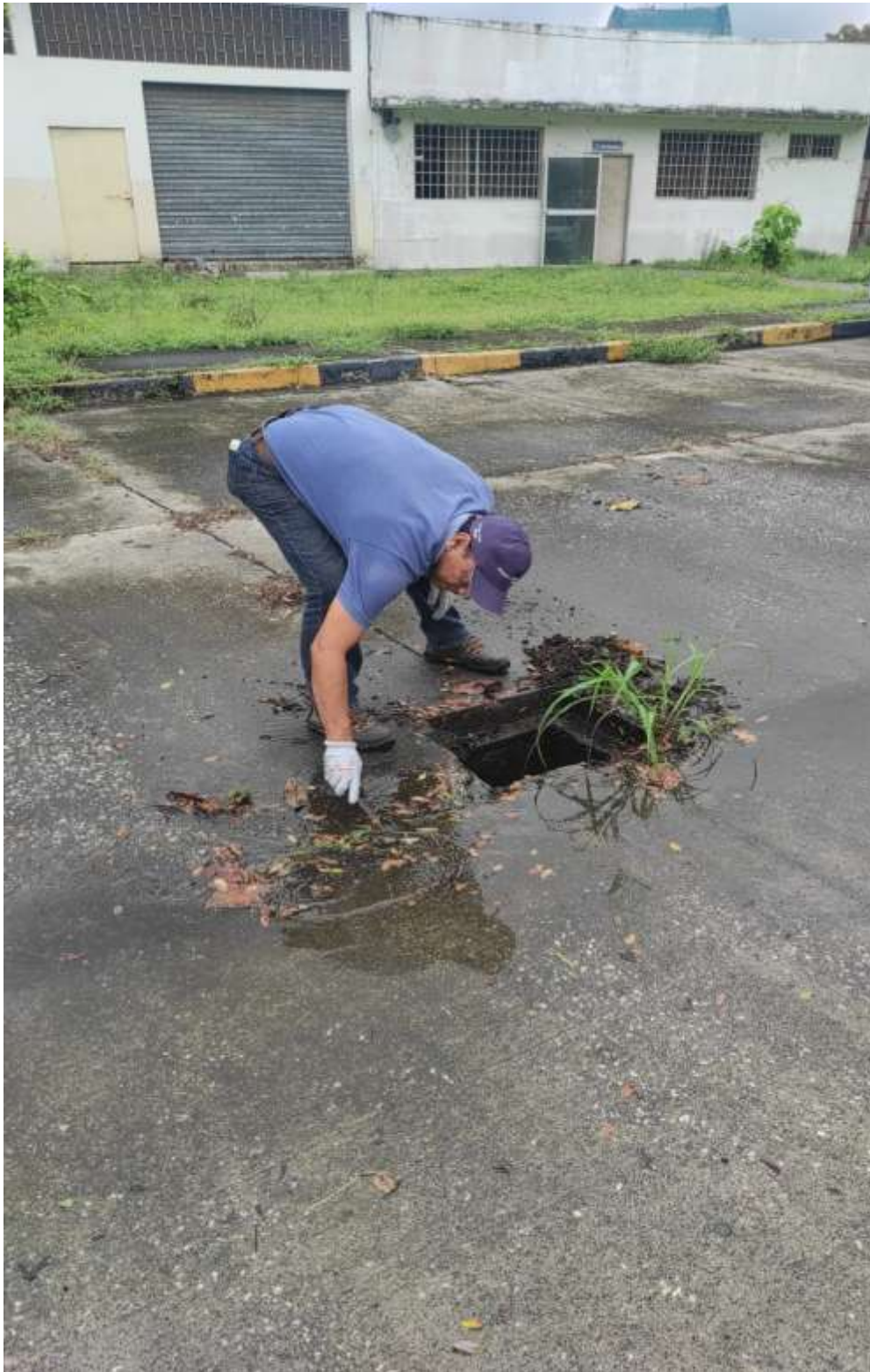
Figura 30. Tapas de registro en mal estado y con escombros
