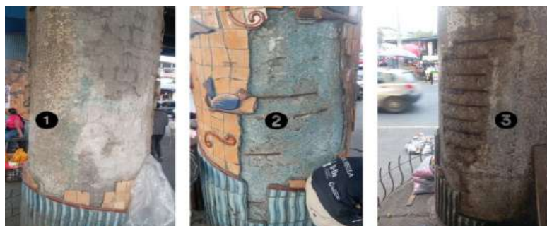
Ilustración 68 desprendimiento de material de recubrimiento de 3 niveles.
