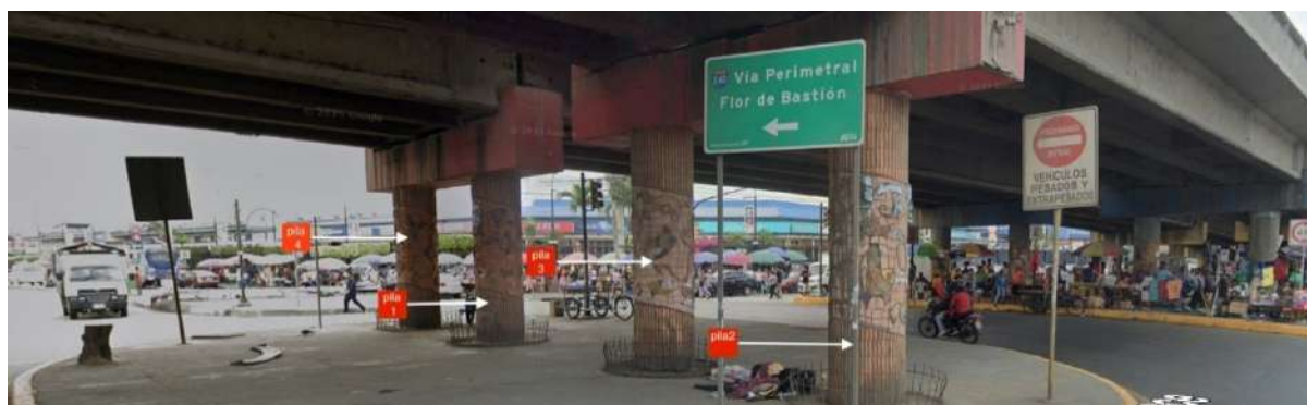
Ilustración 92 Pilas 1,2,3,4 que requieren mantenimiento correctivo
